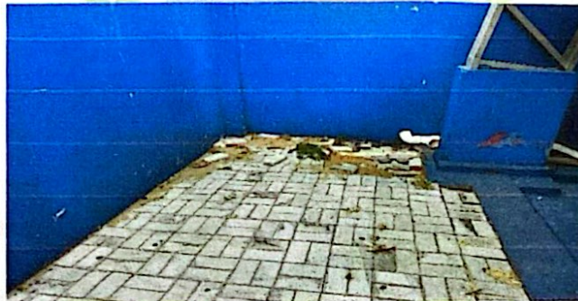
Foto 04: Piso intertravado a ser refeito
