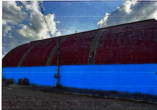
Foto 02: Telhas translúcidas quebradas e quadro de medição obsoleto e com conexões inadequadas
