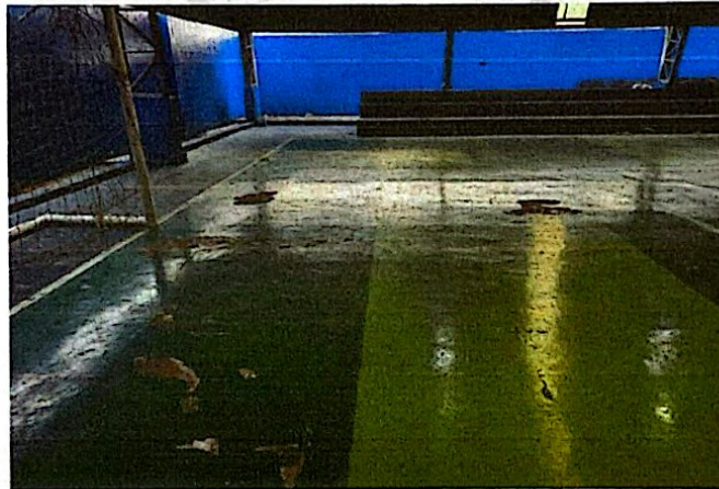
Foto 01: Piso com elevado desgaste por abrasão e irregularidades.
