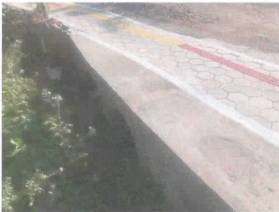
Foto 01: Rua SDO, Bueiros a serem complementados.
