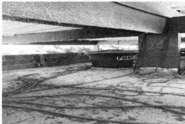
Foto 02: Estrutura de concreto armado aparente e instalação elétrica aparente
