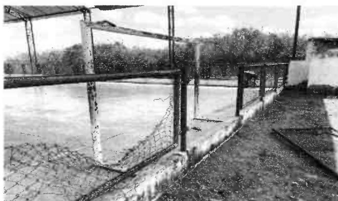
Foto 02: Deterioração dos alambrados
