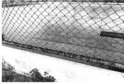
Foto 03: Corrosão acentuada do alambrado
