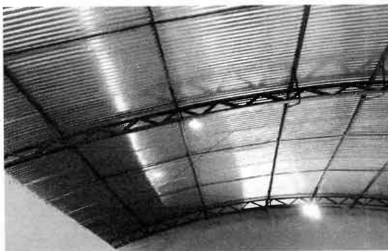
Foto 06: Coberta com elevado número de vazamentos
