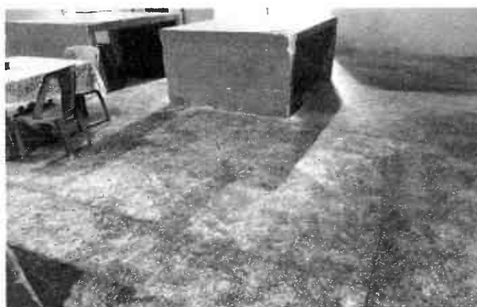
Foto 05: Abrasão acentuada nos pisos industriais
