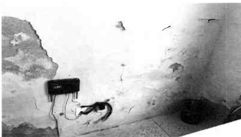
Foto 02: Elevada degradação do revestimento e pintura
