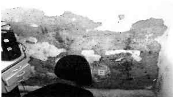
Foto 04: Pulverulência da argamassa no locais com manifestação de umidade por capilaridade.
