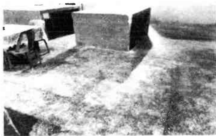
Foto 05: Abrasão acentuada nos pisos industriais
