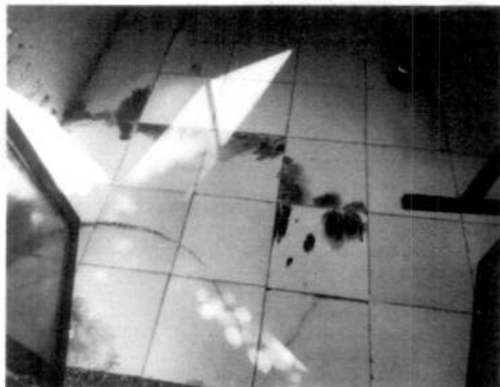
Foto 04: Piso com desgaste
