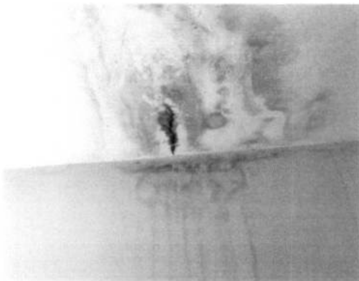
Foto 02: infiltração no forro.
