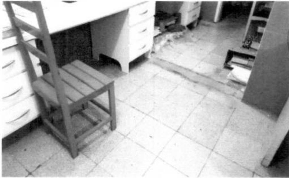
Foto 02: Desgaste das peças cerâmicas.
