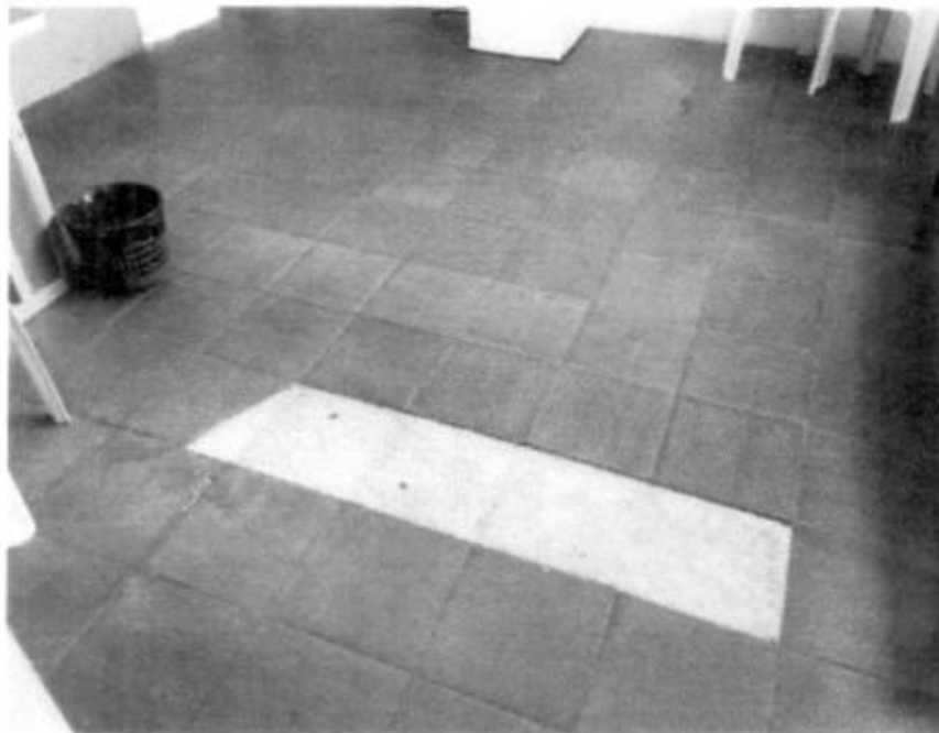
Foto 05: Descolamento de peças cerâmicas.
