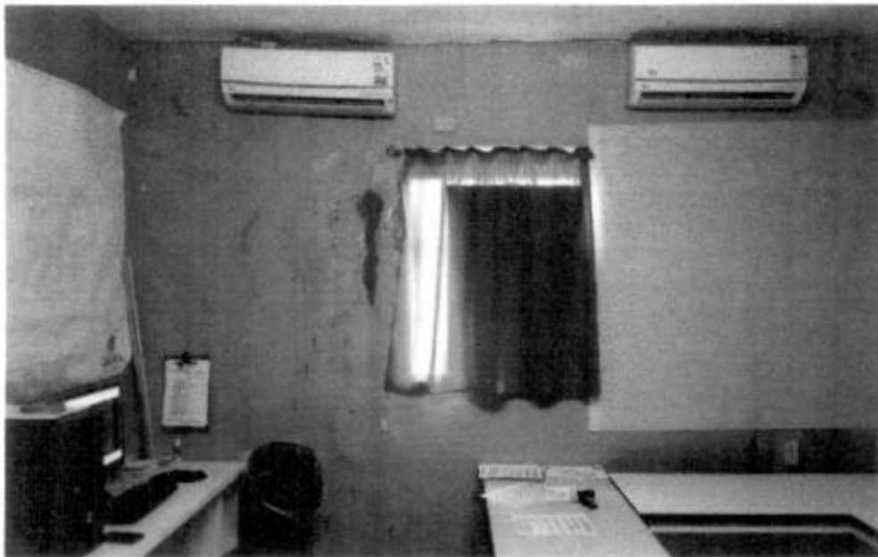
Foto 05: Infiltrações na alvenaria do setor de tributos.
