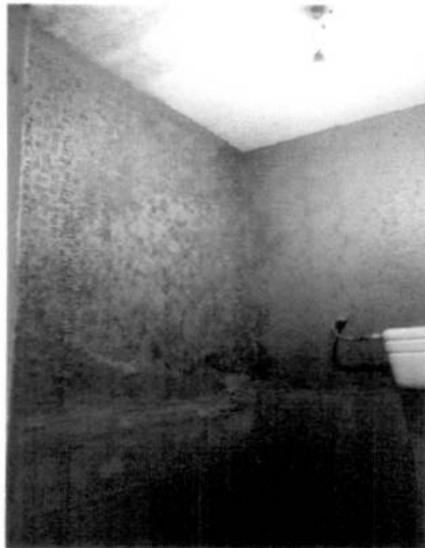
Foto 03: Desgaste da pintura e no revestimento cerâmico do WC
