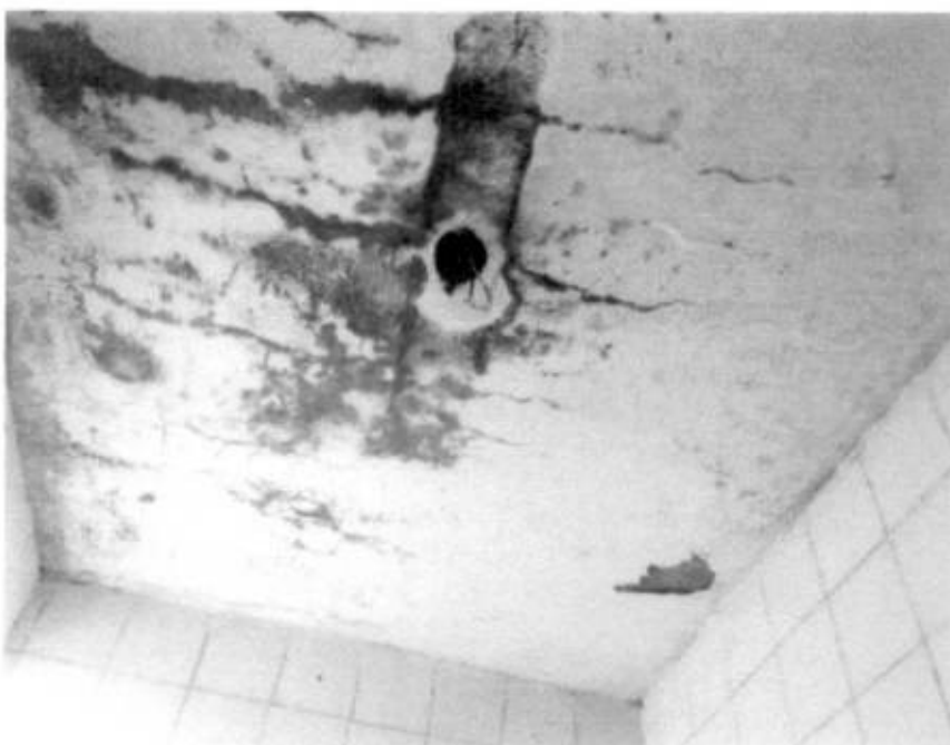
Foto 03: umidade excessiva na laje.
