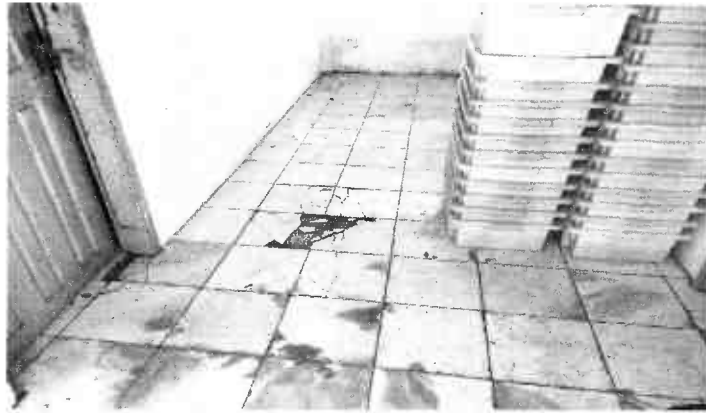
Foto 03: Piso cerâmico com acentuado processo de deslocamento e mudança da tonalidade
