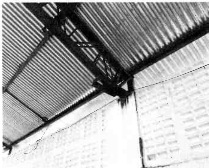
Foto 07: processo corrosivo dos arcos da coberta
