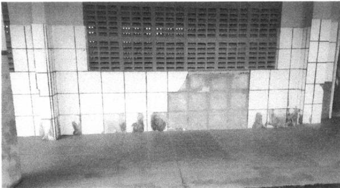
Foto 04: Descolamento e fraturas do revestimento em peças cerâmicas
