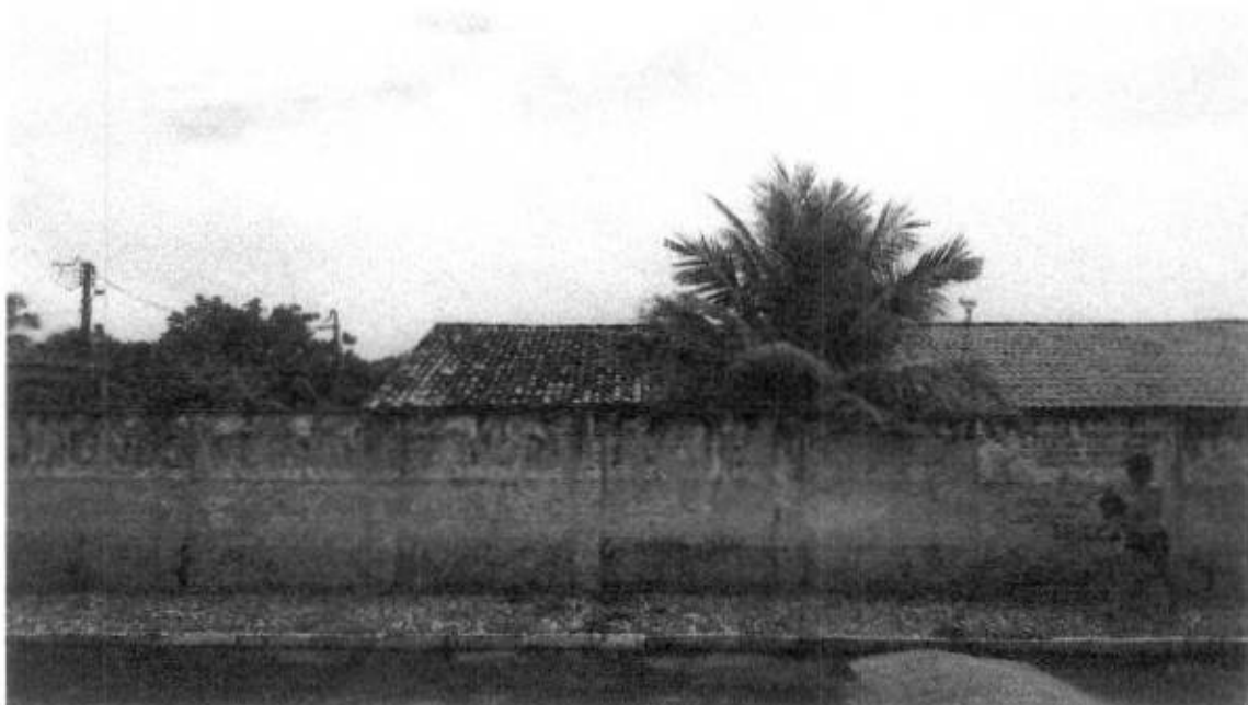
Foto 01: Fachada da edificação com desgaste da pintura e descolamento do revestimento argamassado.
