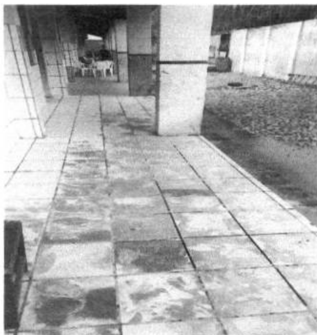
Foto 03: Desgaste intenso do piso cerâmico com descolamento e fraturas de algumas peças cerâmicas.
