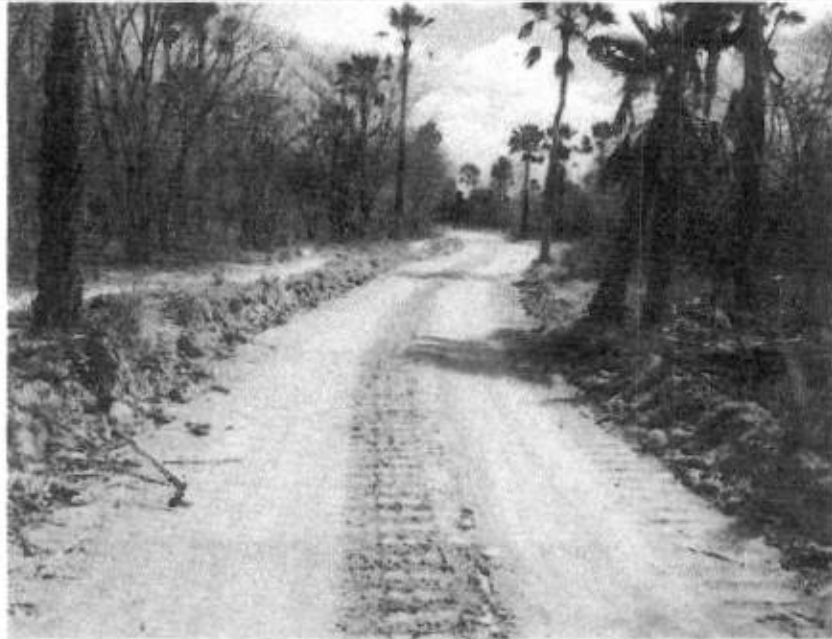
Foto 03 - local do qual a estrada esta captando água motivo do qual é planejado a terraplenagem.
