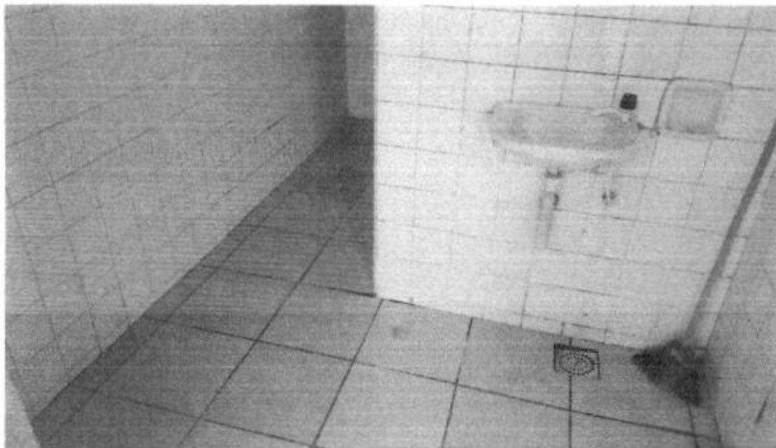
Foto 05: Banheiros sem acessibilidade
