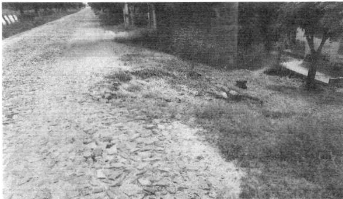
Foto 01: Pavimento e meio fio danificados
