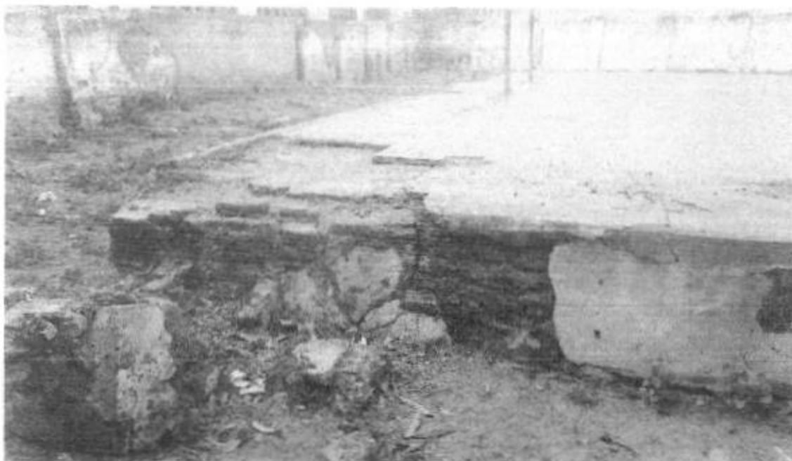
Foto 04: Deterioração do piso em quadra anexa ao cras
