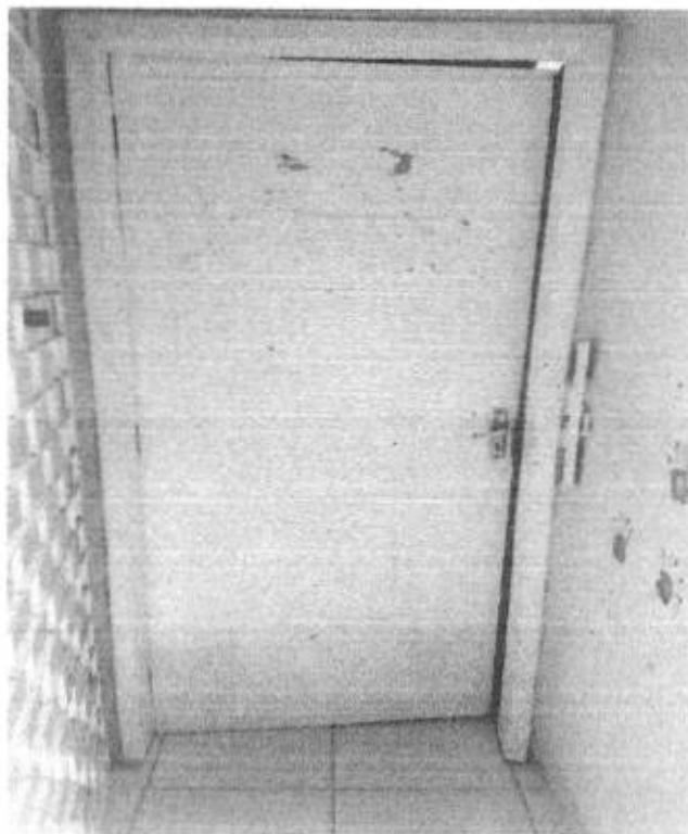
Foto 05: Esquadrias desgastadas e com acessibilidade insuficiente
