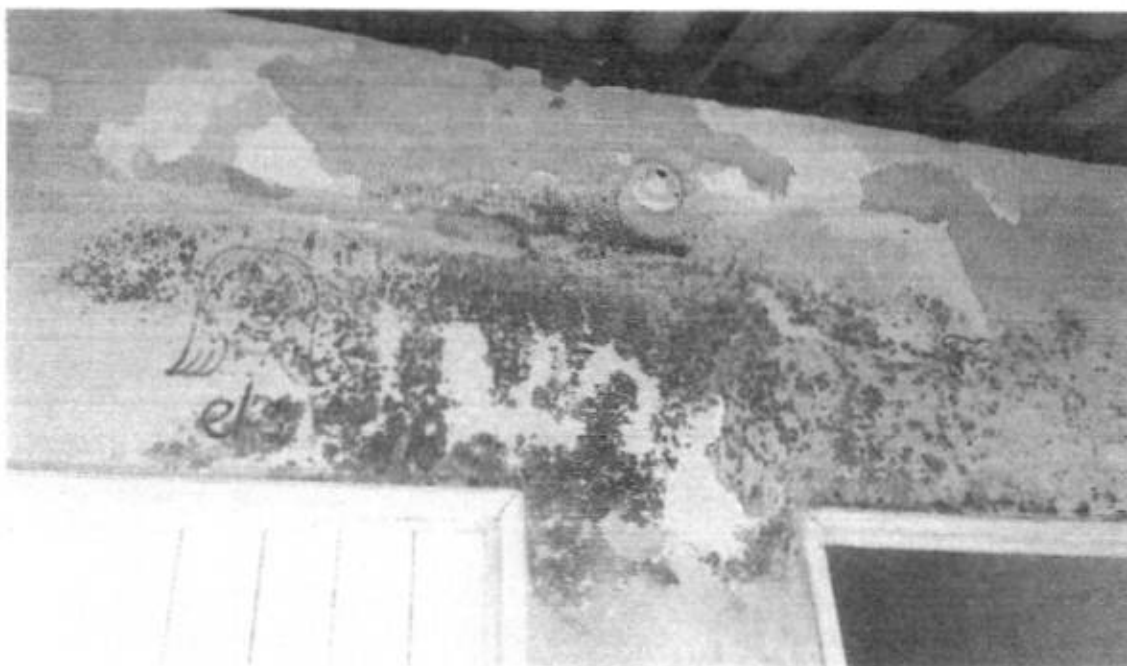
Foto 03: Elevada presença do bolor nos ambientes laváveis
