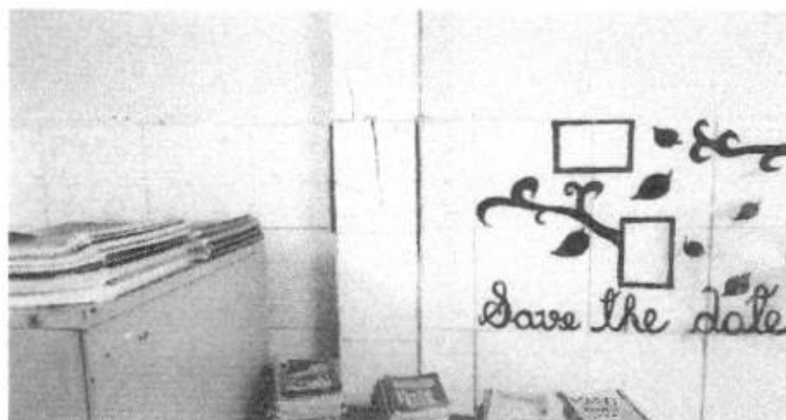
Foto 04: Descolamento dos revestimentos cerâmicos
