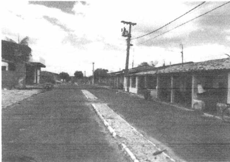
Foto 01: Acentuado desgaste dos canteiros
