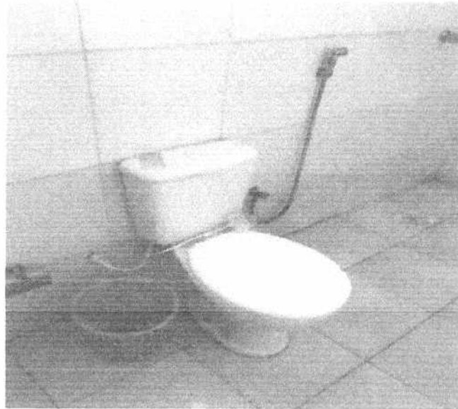
Foto 03: Sanitário sem acessibilidade na edificação
