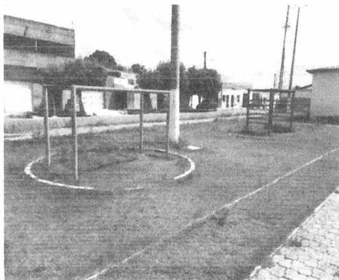
Foto 06: Meio fio desgastado por intemperismos físicos e pavimentação com pigmentação falha
