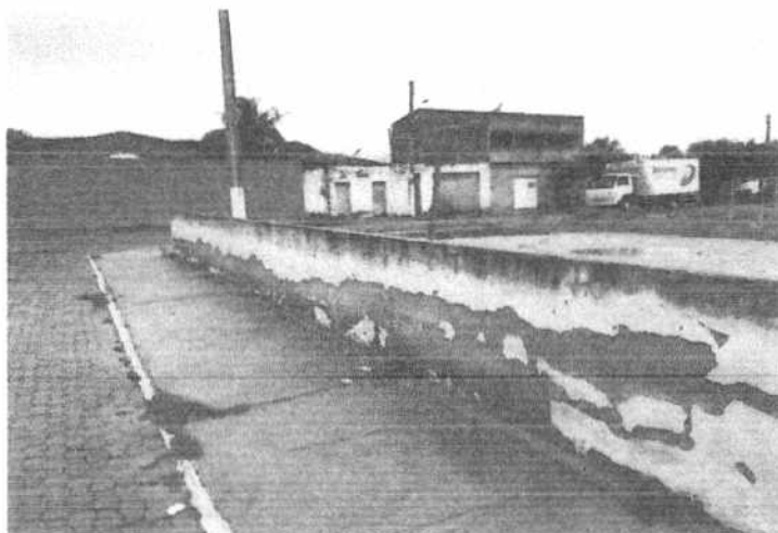
Foto 01: Arquibancada com elevado descolamento do revestimento argamassado (alta porosidade em função de um traço com proporções elevadas)
