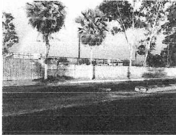
Foto 04: O muro frontal apresenta altura insuficiente assim como elevado tempo de utilização com eventual risco de desabamento se houver carreamento do aterro.
