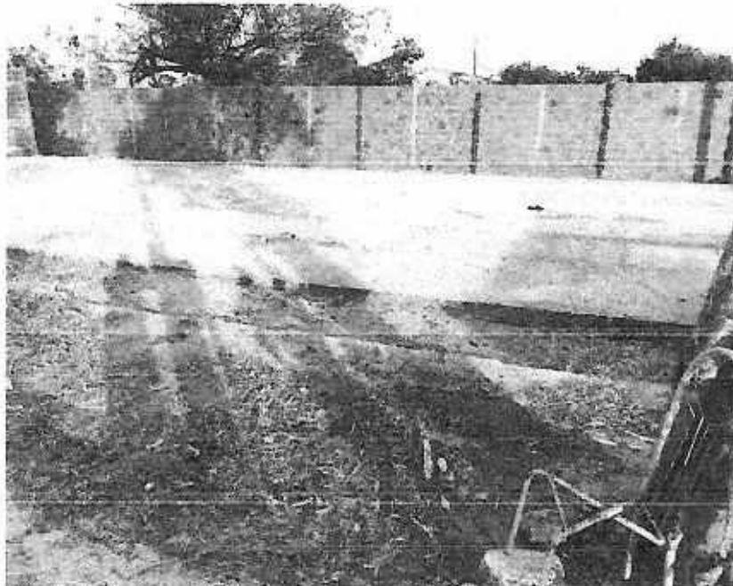
Foto 03: O muro da lateral direita da edificação sofreu um desabamento em todo seu perímetro, sendo necessário a completa restauração da vedação lateral para proteção do patrimônio público.
