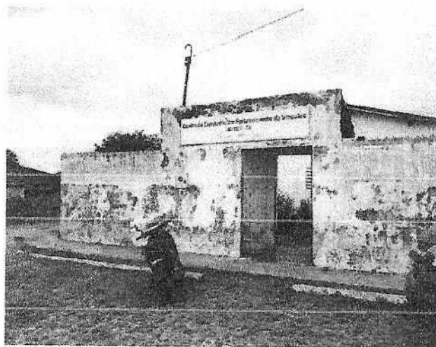
Foto 01: Fachada da edificação com elevado desgaste na pintura e no revestimento argamassado
