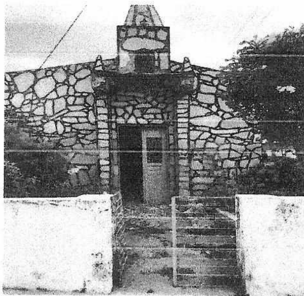
Foto 01: Fachada da edificação com risco de desabamento
