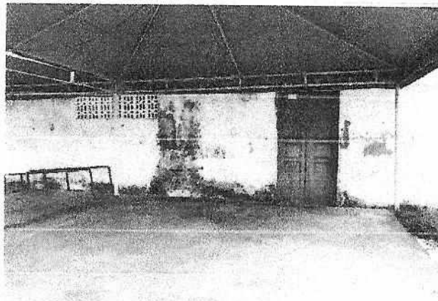
Foto 08: Fachada interna com degradação no revestimento e pintura
