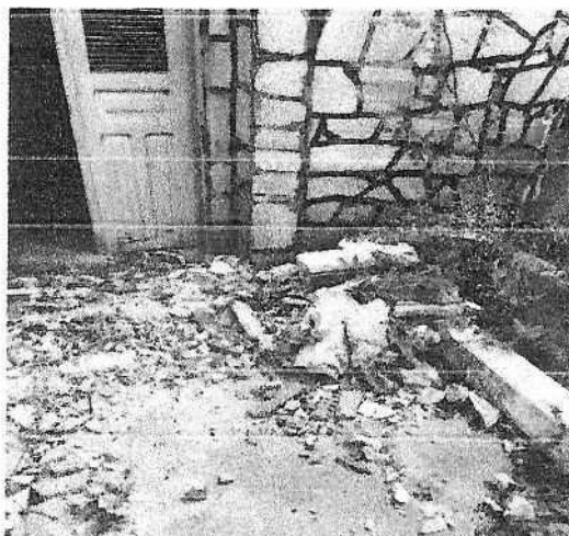
Foto 03: Desabamento parcial da fachada
