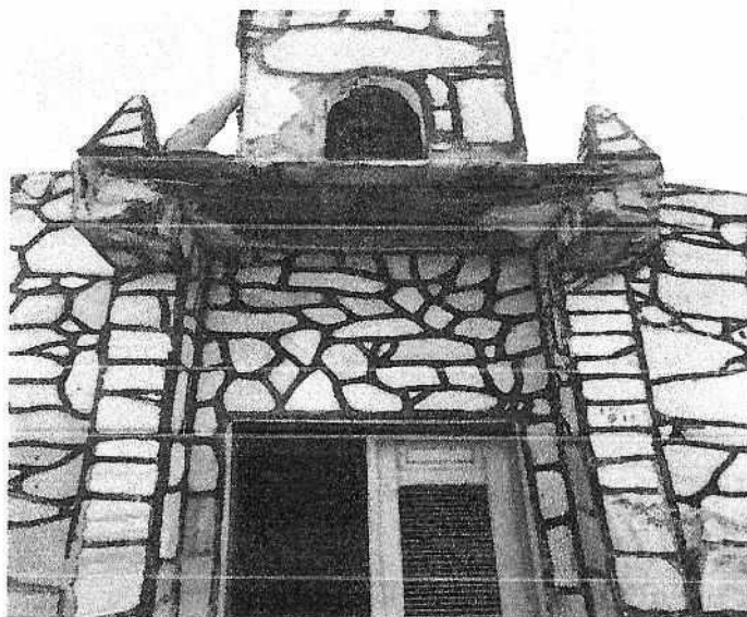
Foto 09: Laje em balanço com risco de desabamento
