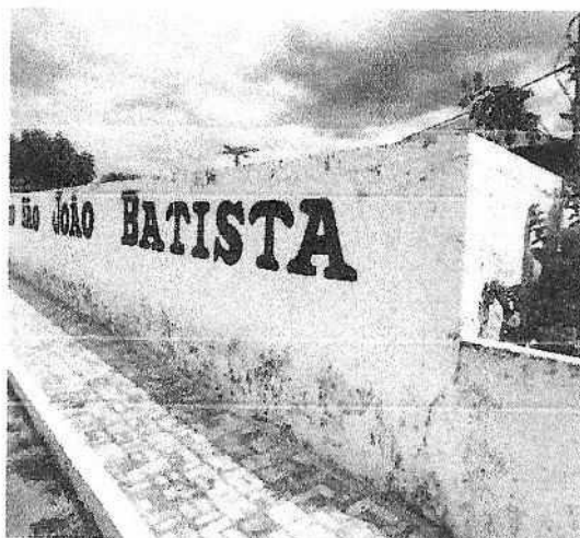
Foto 04: Muro da edificação com pintura desgastada
