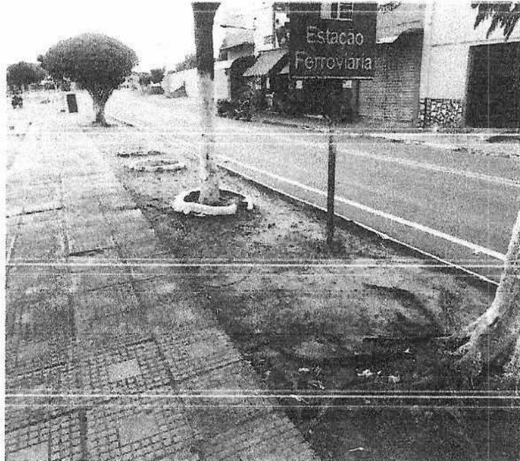
Foto 04: Ambiente externo com elevada degradação do pavimento em concreto
