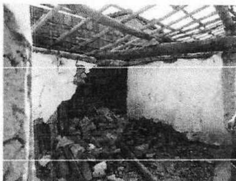
Foto 05: Desabamento parcial, com risco de colapso integral
