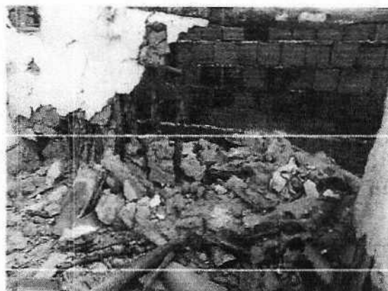
Foto 02: Local do sinistro
