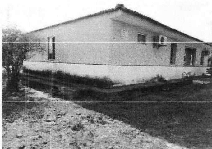
Foto 01: Fachada da edificação, com eflorescência da pintura
