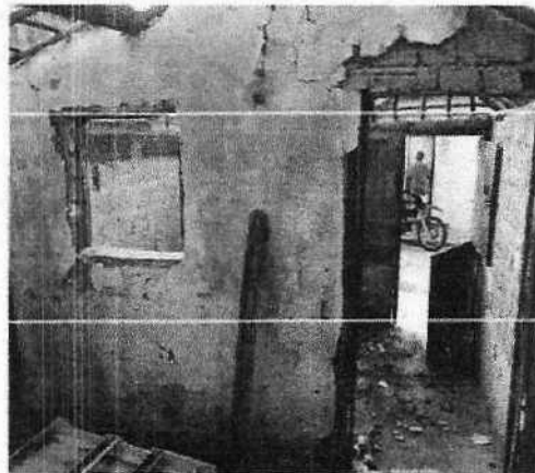
Foto 04: Local do sinistro
