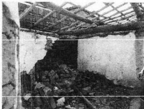
Foto 05: Desabamento parcial, com risco de colapso integral
