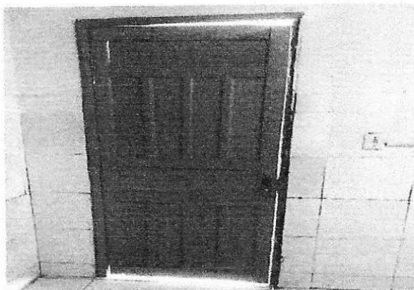
Foto 04: Esquadrias com elevado desgaste
