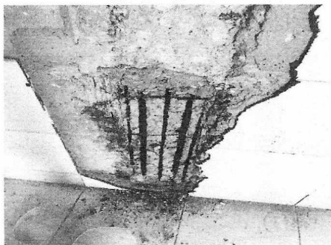
Foto 01: Armadura longitudinal dos pilares existentes com elevado processo corrosivo
