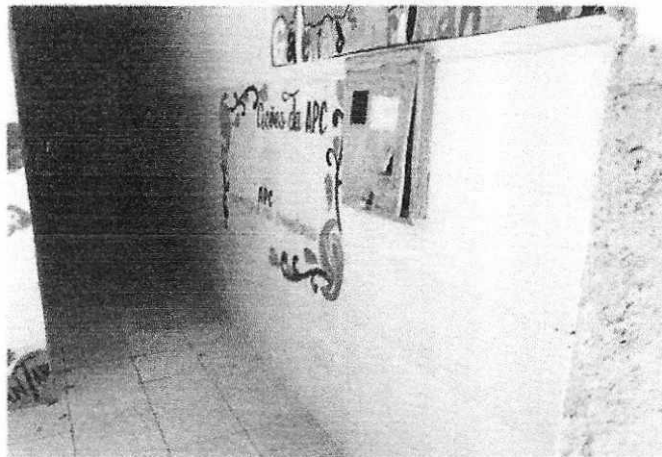
Foto 07: Instalações elétricas executadas de maneira errônea .
