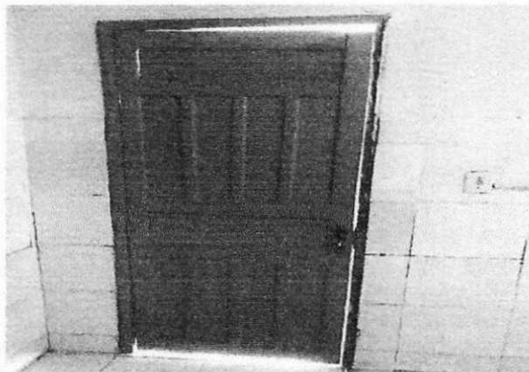
Foto 04: Esquadrias com elevado desgaste
