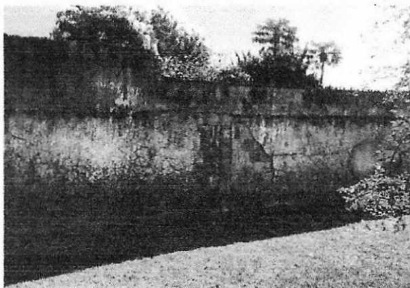
Foto 05: Muro com deslocamento do revestimento argamassado
