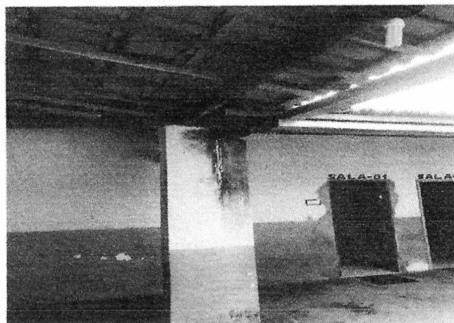
Foto 02: Coberta com um elevado número de infiltrações
