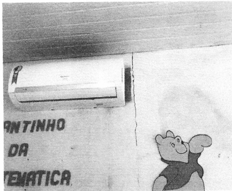
Foto 04: Trincas e fissuras na alvenaria da edificação
