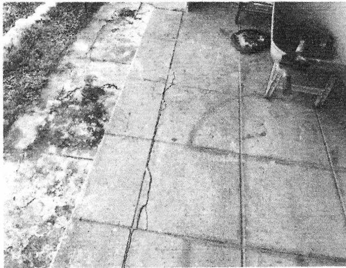
Foto 05: Trincas e rachaduras no piso externo
