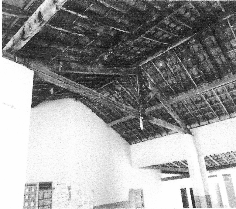
Foto 03: Madeira e telhas com elevado desgaste físico
