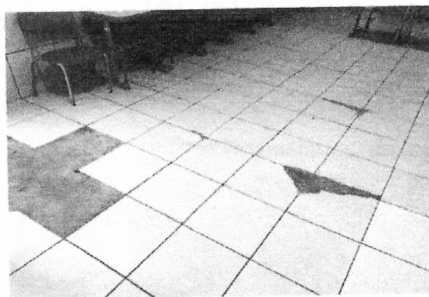
Foto 05: Deslocamento do piso cerâmico
