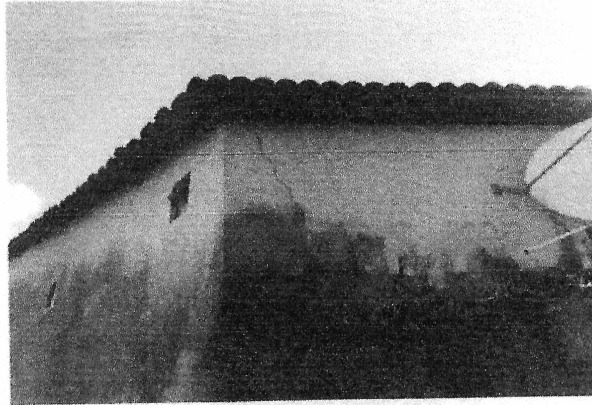
Foto 03: Trincas e fissuras na alvenaria da edificação
