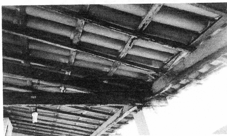
Foto 02: Madeiramento da cobertura com elevada infestação por cupins
