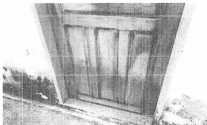
Foto 05: Porta com elevado desgaste
