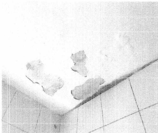
Foto 01: Descascamento da pintura
